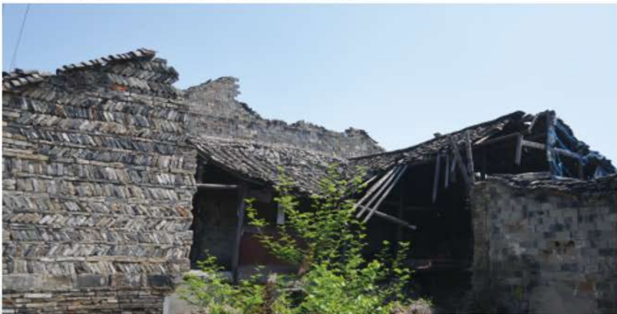
调研途中随处可见的破旧老建筑
